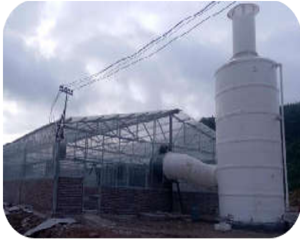
图 61 尾气收集除臭设备
