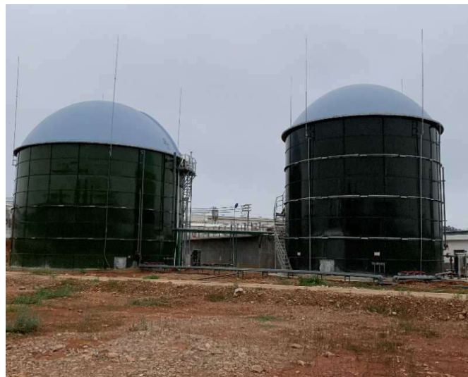
图 17 UASB 厌氧发酵罐
